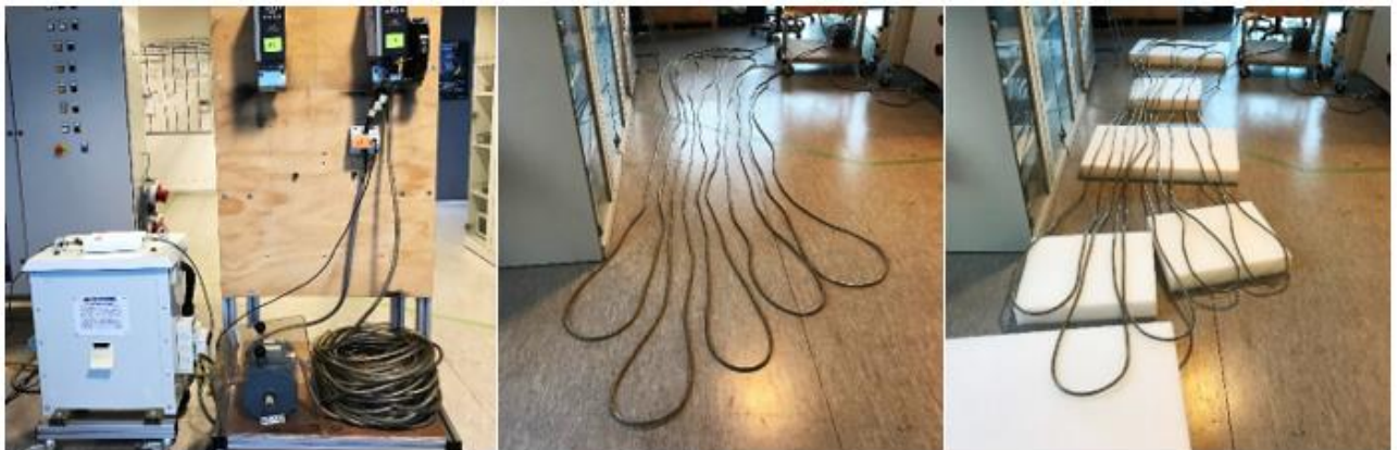
Abbildung 35: Testaufbau mit Aufgerollt, Abgerollt und Abgerollt + Isoliertes Motorleitung
